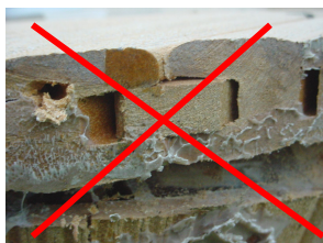
Geen voeghout tussen de planken
